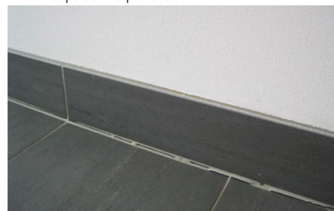
Obr. 26 Potrhaná dilatační spára bez použití separačního provazce
