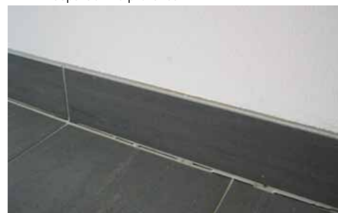
Obr. 26 Potrhaná dilatační spára bez použití separačního provazce
